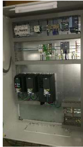
Inverter in armadio PLC esistente
